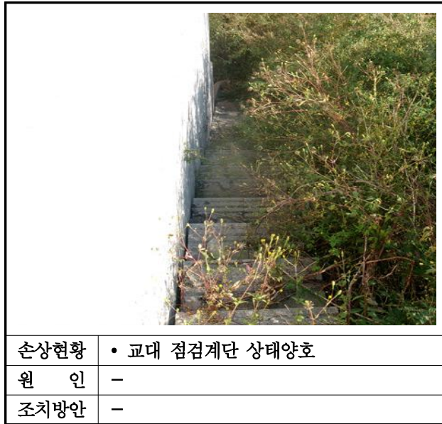
【사진 23.3.51】 교량 점검시설 손상현황
